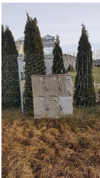
Widok ist. złącza kablowego ZK
